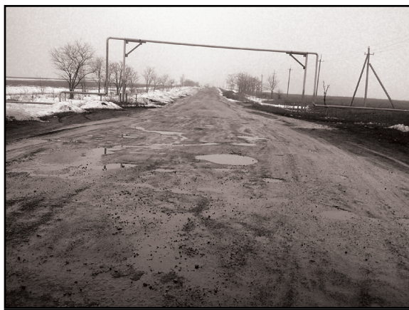
Судя по акту осмотра дорожного покрытия, сделанного ДРСУ г. Антрацита, дорожное покрытие на пос. Нагорный такое, как на МЕЖИГОРЬЕ – поместье Виктора Януковича. Хотя со времен распада СССР, эта антрацитовская дорога вообще никогда не ремонтировалась
